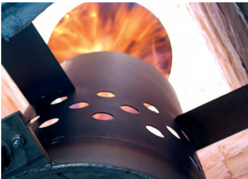
Unité de biogaz combustible.
