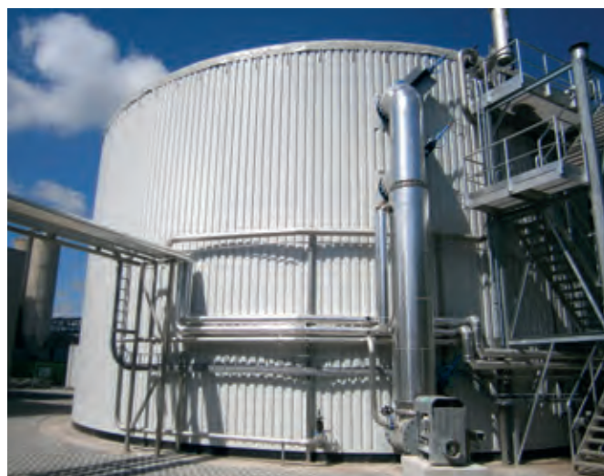
Enprotech Anaerobic Biogestor pour Pepsico Veurne (B).
